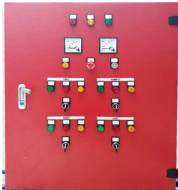
Hình 2.1. Tủ điện điều khiển bơm chữa cháy trong trạm bơm chữa cháy tự động
